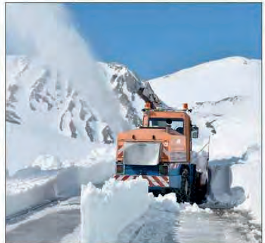
À la fin du travail de la fraiseuse, une balayeuse passe et un artificier du département autorise l'ouverture au public.
